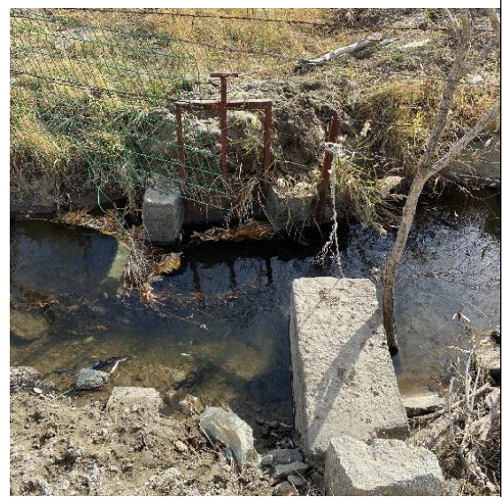
阿克塔木干渠：衬砌段损毁
